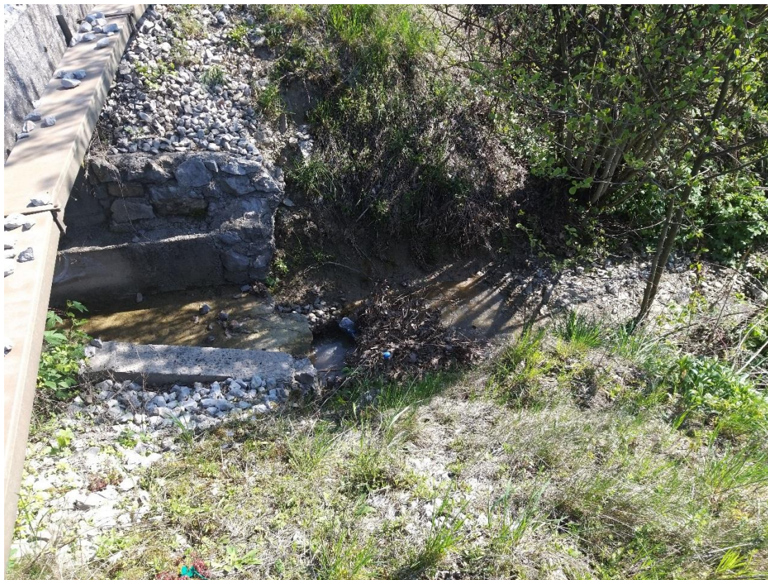
foto 23: prepust A15 – Istočna stran prepusta. Vidna je erozija dna in leve brežine
